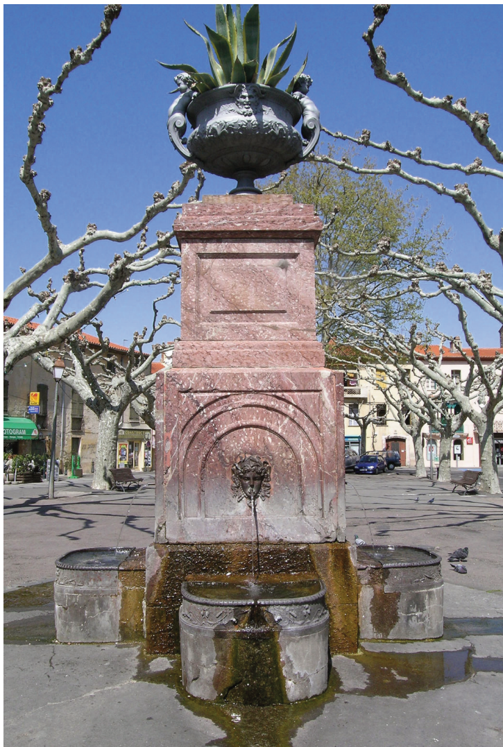
Fig. 13. Prades (Pyrénées-Orientales), fontaine en marbre griotte de la Place de la République, 1867. Vue prise avant sa récente restauration, avec les fuites du réservoir venant du montage par collage de plaques. © Cécile Respaut.
