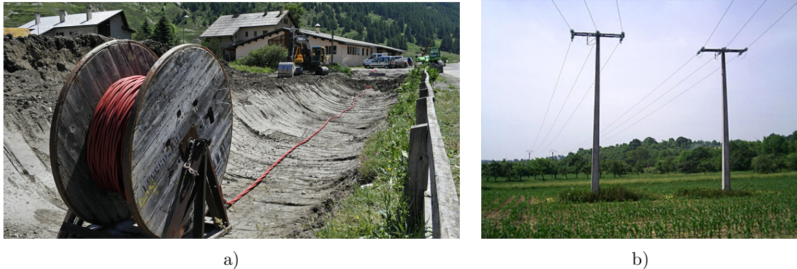
Figure 1.17 – a) Enfouissement d'une ligne HTA 20 kV Axat (11) - b) Ligne aérienne Lauragais (11)
