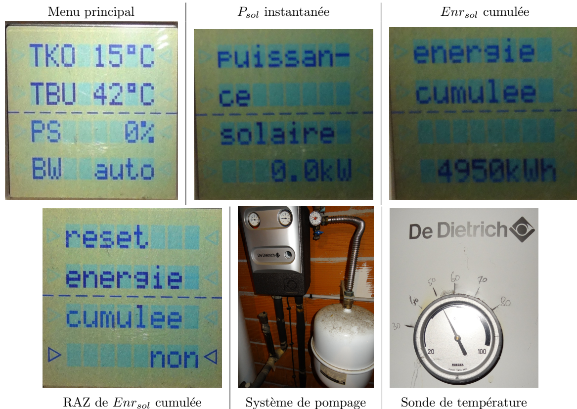
Figure 3.9 – Quelques captures d'écran du contrôleur et visuels de l'installation solaire
