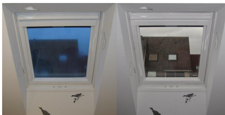
Figure 3.19 – Un cas de vitrage HS sur un VELUX
